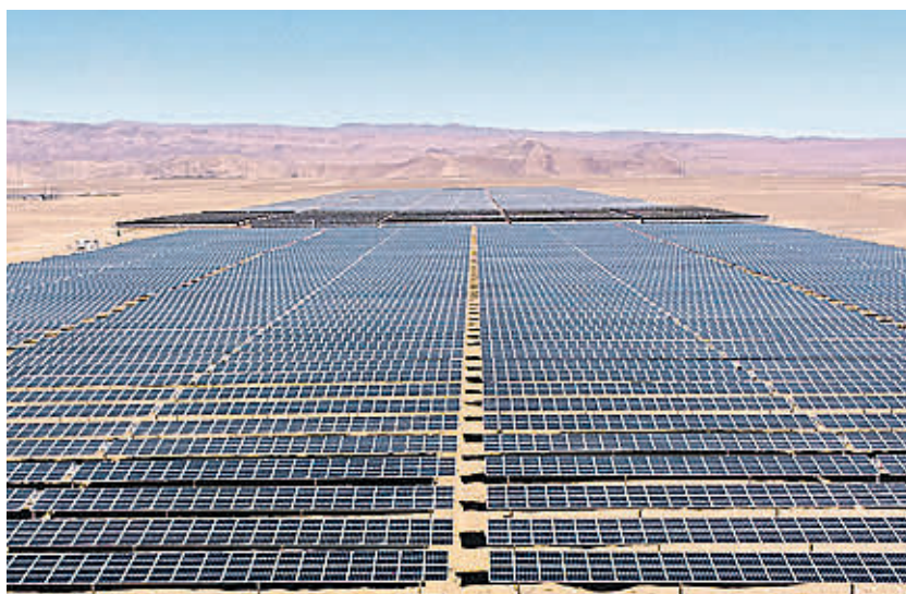
Placas solares. eE
